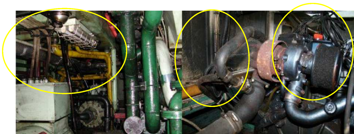
機関室の配線
